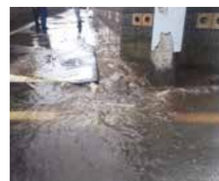
平成28年度 川越市内溢水状況
